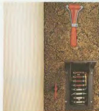
Sicherungskasten, Hauptschalter für Wohnraumelektrik.
