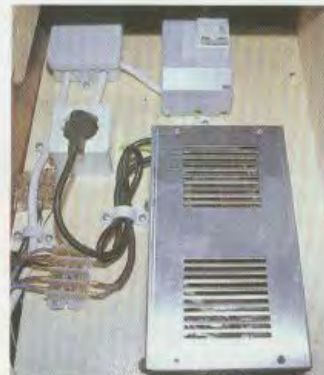
Ladegerät und Sicherungsautomat.
